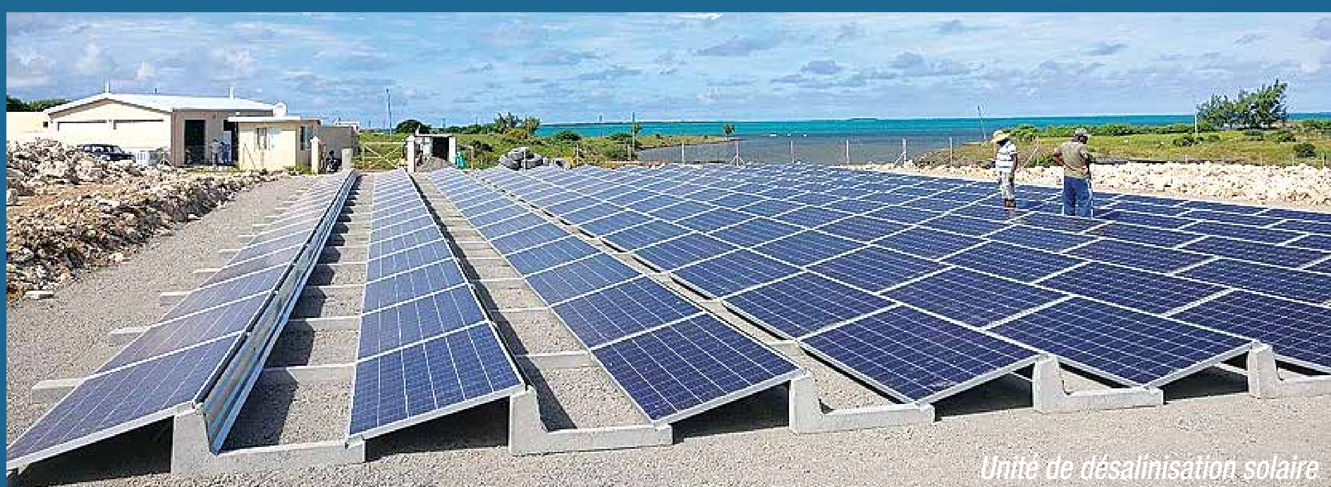
Unité de désalinisation solaire
